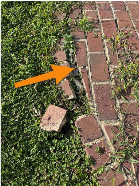
Loose bricks on edge
