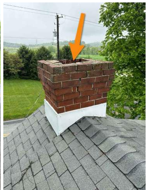
Left Side Chimney
