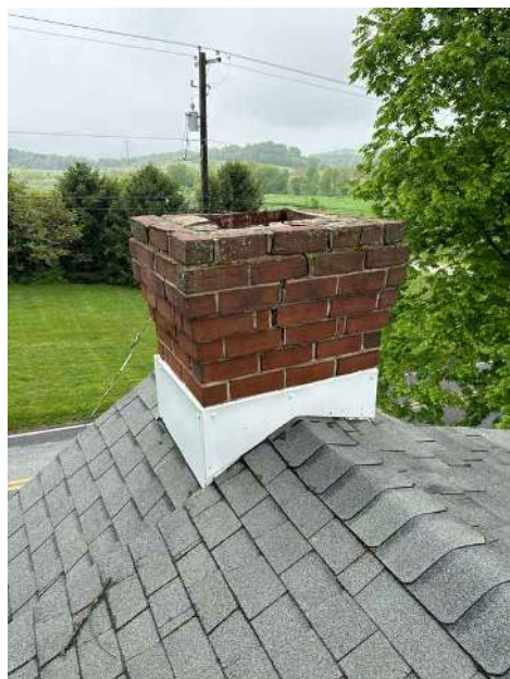
Left Side Chimney
